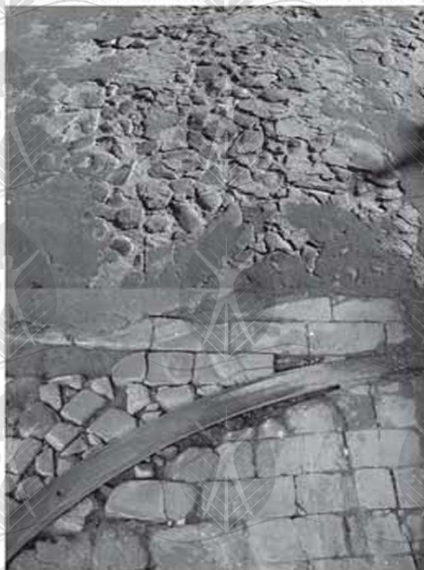
Figura 15. Calçamento original do arruamento.
