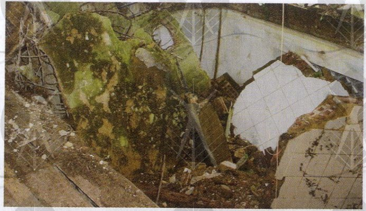
Interior do imóvel. Os panos de laje existentes na construção desabaram no período de chuvas do mês de dezembro do ano de 2005.
