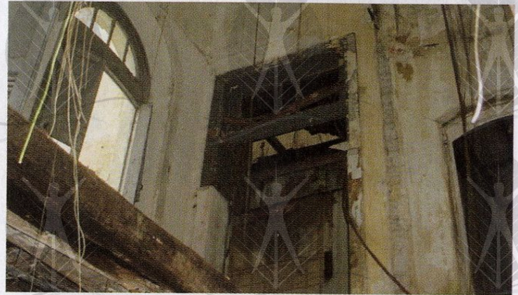
Interior do imóvel. Esquadrias em madeira vistas pela face interna apresentando processo acelerado de degradação.
