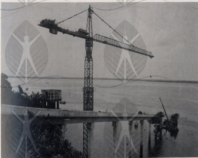
Captação de água bruta da nova tomada d'água.
